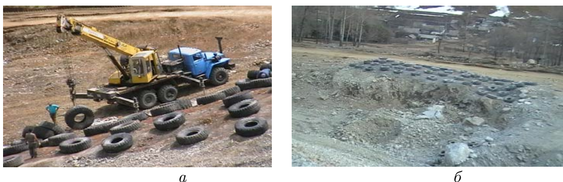
Рис. 3. Укрытие в виде мата из автомобильных шин: а - укладка шин автокраном; б - общий вид укрытия.
